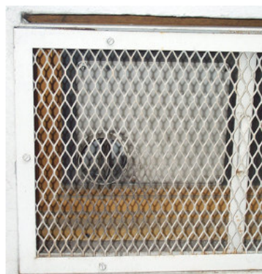
Ventilateur d'extraction de la salle d'archives
