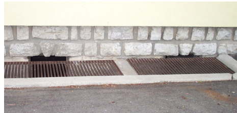
Entrées d'air naturelles de la chaufferie
